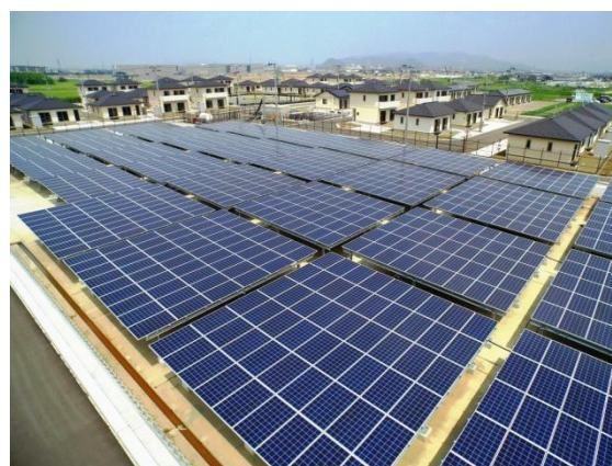
防災調整池に設置した太陽光発電システム
