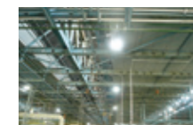
パネル工場照明のLED化
