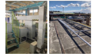
乾燥炉熱源の変更 (ボイラー熱から パーナー化) ボイラードレンの回収・ 再利用
