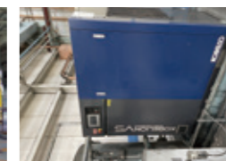
高効率コンプレッサーへの更新
