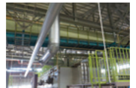
廃熱利用(乾燥炉)
