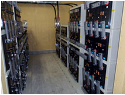
大型蓄電池（改修後）
