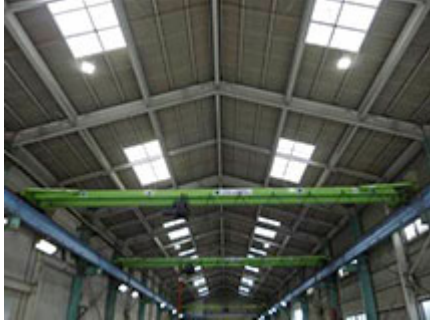
天井照明のLED化
