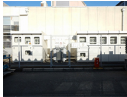
高圧トランスの高効率化
