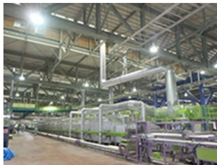
ベルバーン成形工場LED照明
