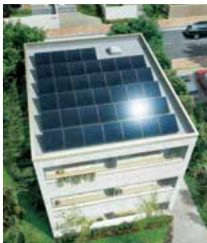
据え置き型太陽光パネル
