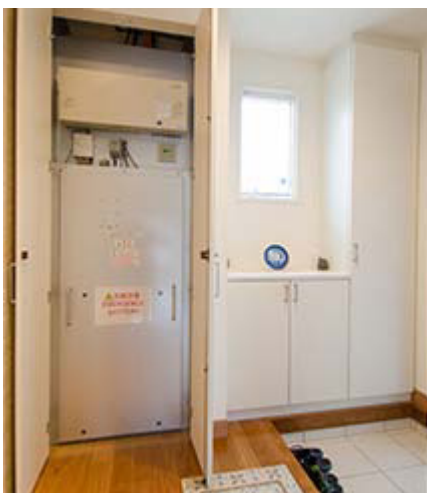
玄関ホールに収納された蓄電池システム
