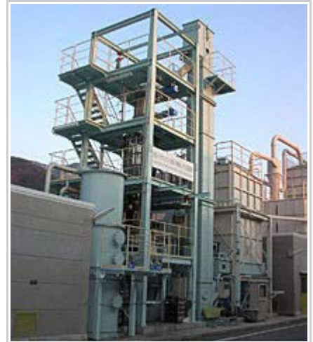
木質バイオマスプラント概観
