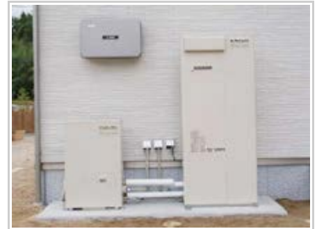
設置されたSOFC型エネファーム (LPガス仕様)
