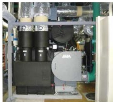
氷蓄熱式冷凍機
