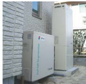
戸建住宅14棟すべてに家庭用燃料電池を設置
